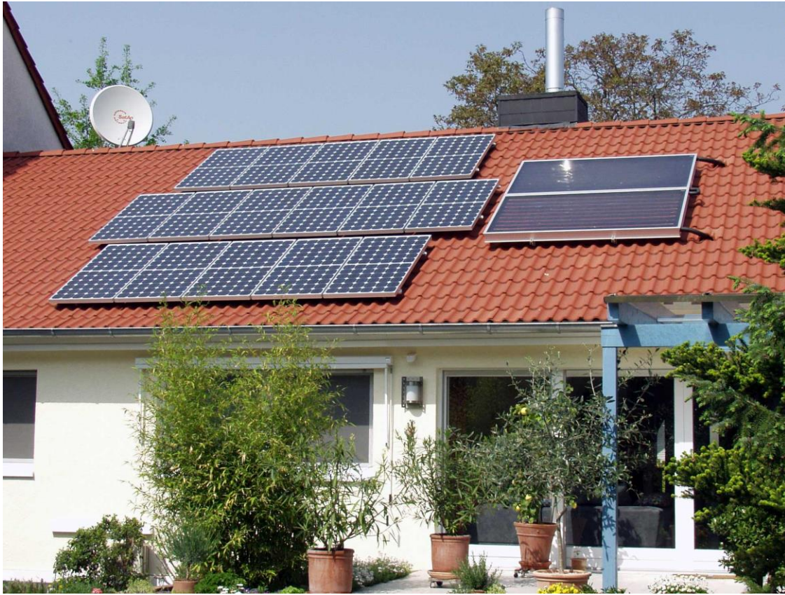
4.5. ábra: Napelemek (középen), illetve napkollektorok (jobb oldalt) lakóház tetején
